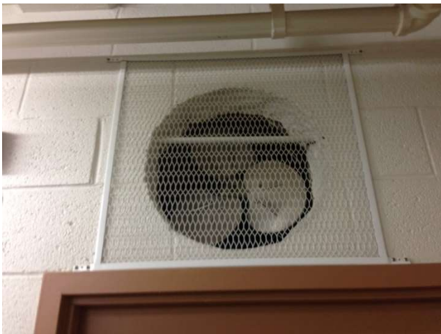
Basement room ventilation fan
