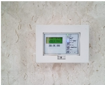
Fire alarm annunciator
