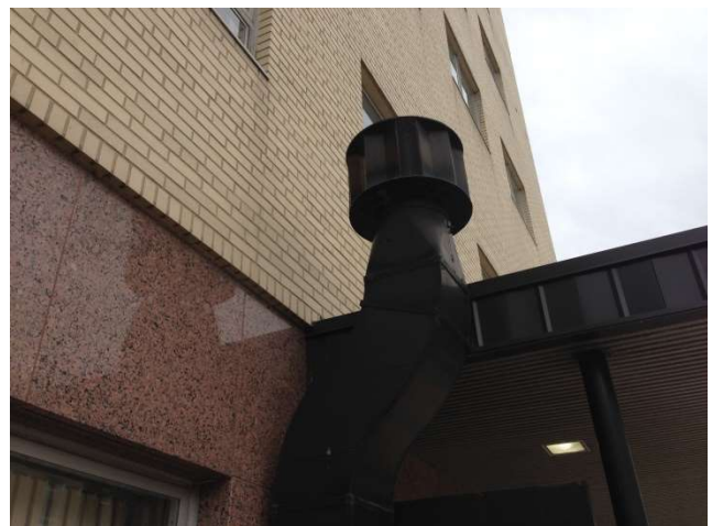
Exhaust fan discharge (abandoned)
