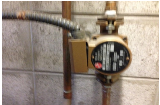
HWR Recirculation pump
