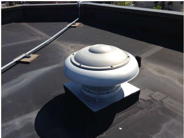
Kitchen exhaust fan
