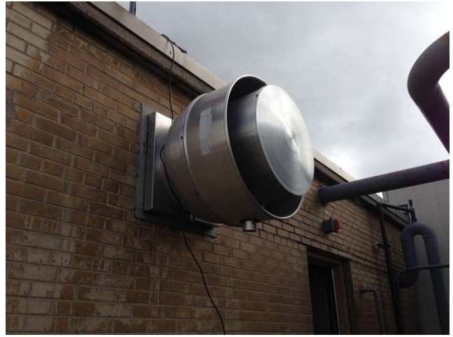
Mechanical room fan
