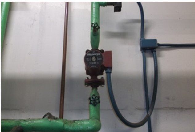
HWR recirculation pump
