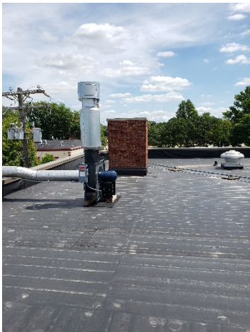
Vehicle exhaust fan
