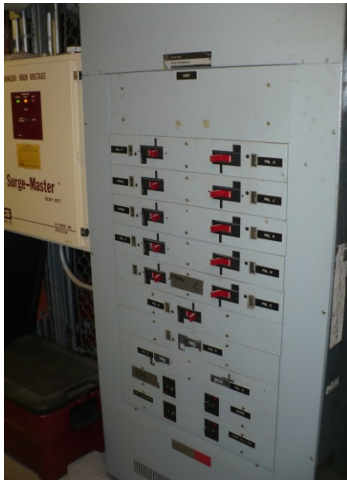
EM main distribution panel
