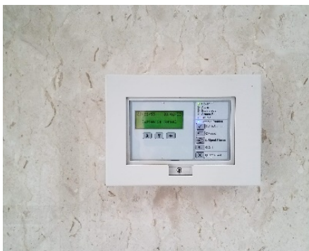
Fire alarm annunciator
