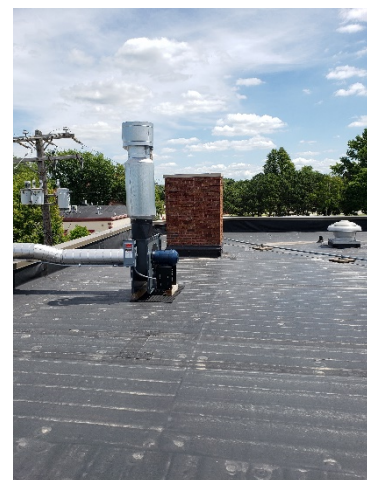
Vehicle exhaust fan
