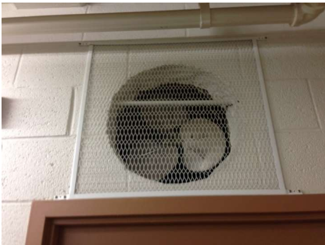
Basement room ventilation fan
