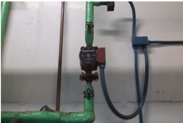
HWR recirculation pump
