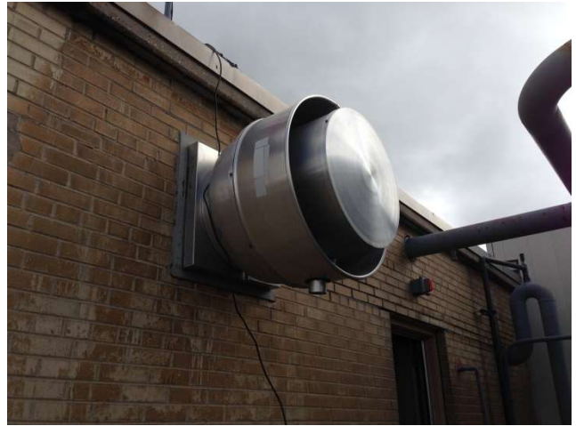
Mechanical room fan
