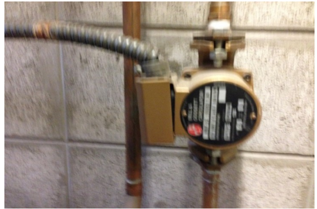
HWR Recirculation pump
