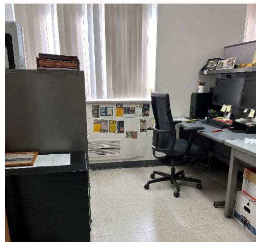
Bent louver blades
