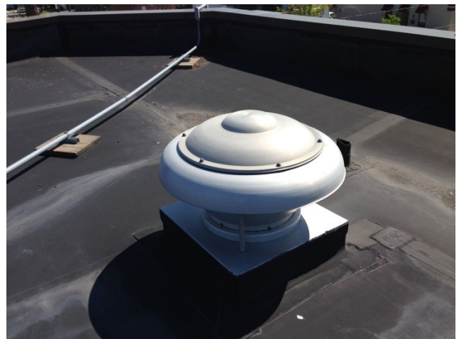
Kitchen exhaust fan
