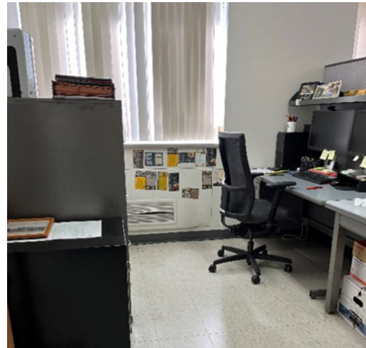
Bent louver blades
